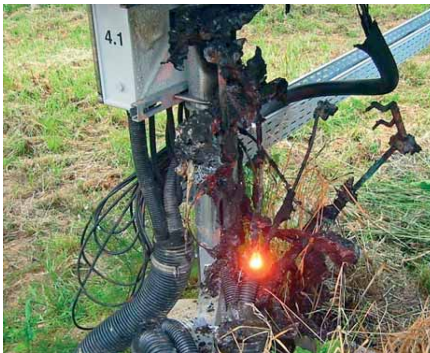
Rys. 2. Uszkodzona instalacja zasilająca kolektora
